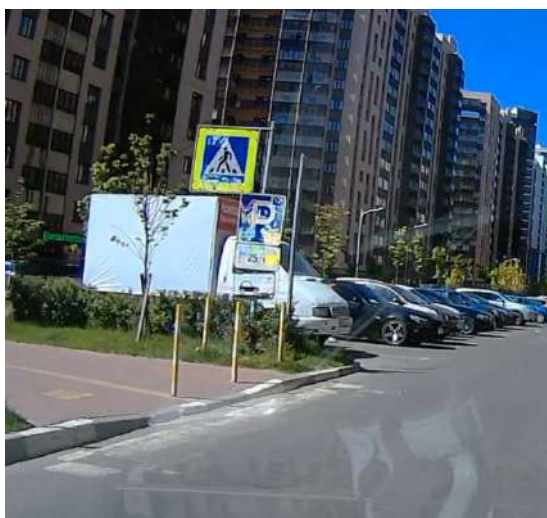
Рисунок 2.7.1.2 – Эксплуатационное состояние дорожных знаков не соответствует требованиям ГОСТ Р 50597-2017, бульвар Менделеева, МО «Муринское городское поселение»
