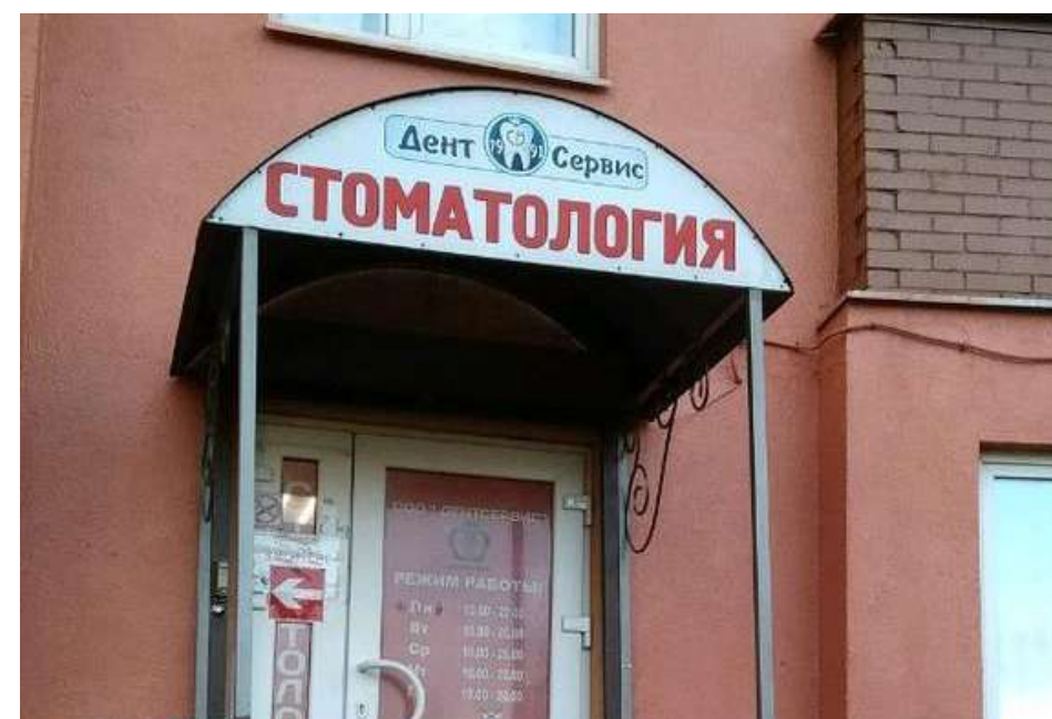
Самостоятельная надстройка вмешивается в архитектуру здания.
