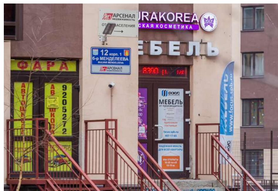
Расположение вывесок одна над другой; полное перекрытие светопрозрачных конструкций.
