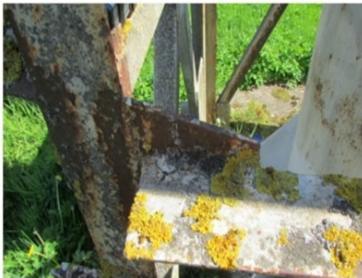
Состояние до ремонта
